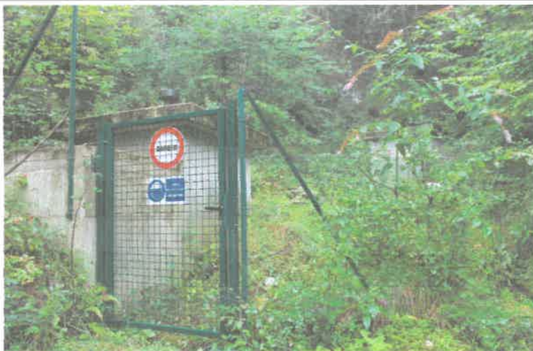
En arrière plan, l'ouvrage du captage. A gauche, le réservoir et son capot FOUG. Le PPI est délimité par l'abrupt d'où jaillit la source (au fond) et par la clôture constituée de barbelés.
