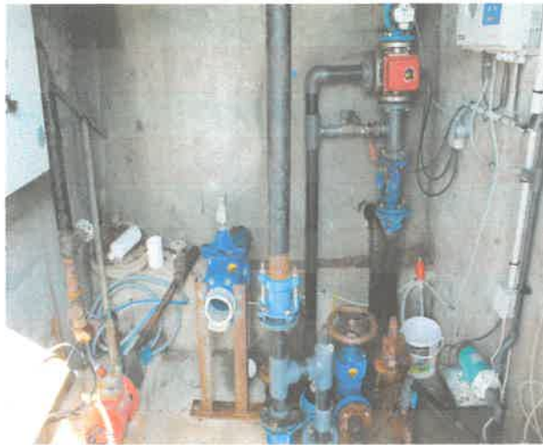
Détail des installations de traitement et d'acheminement à l'intérieur du réservoir
