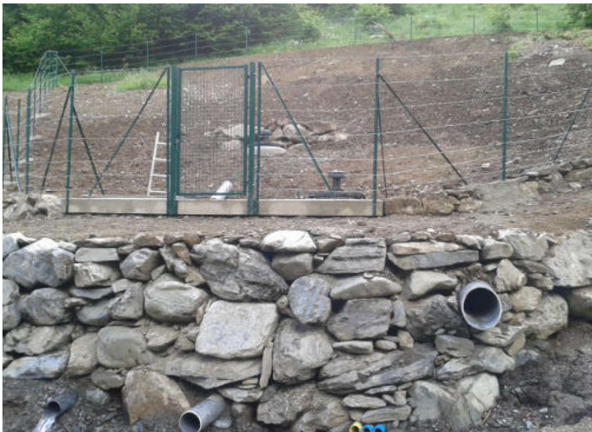
Figure 8. Photographies du captage aménagé de la source Armory Nogué -15/06/2016 (Source : ANTEA)
