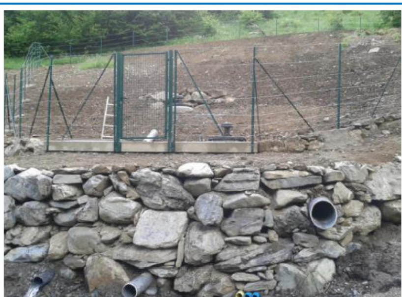
Figure 18. Photographies du captage aménagé de la source Armary Nogué -15/06/2016 (Source : ANTEA)
