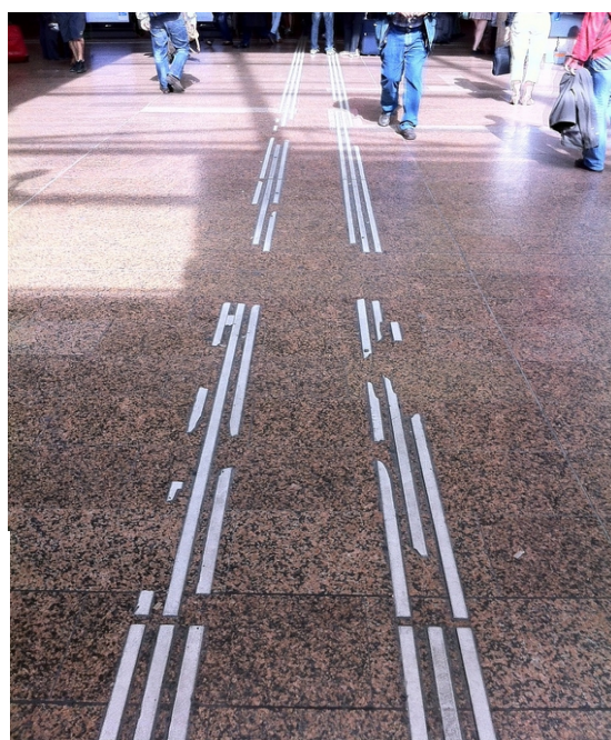
Illustration 20 : en ERP très fréquenté et soumis à de fortes sollicitations, les dispositifs de guidage détériorés doivent être remplacés pour rester efficaces.
