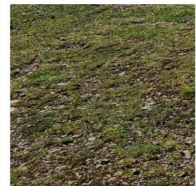
04 - Toiture terrasse revégétalisées avec espèces endémiques sélectionnées
