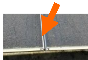
Les panneaux sont espacés, sur chaque bord, de sorte à pouvoir évacuer les eaux de pluie interceptées
