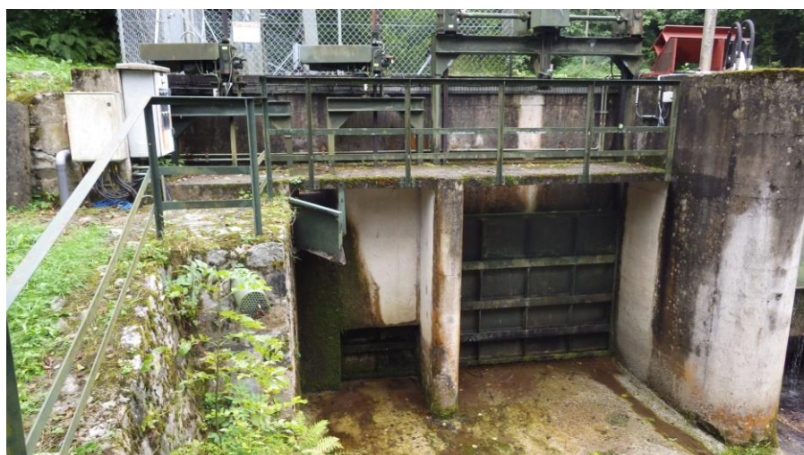
Figure 4 - Zoom sur la vanne de chasse (RG)
