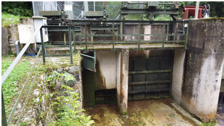
Figure 4 - Zoom sur la vanne de chasse (RG)
