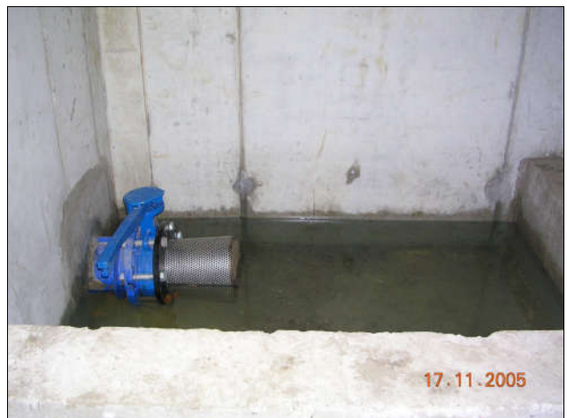
Bassin de mise en charge de la crépine
