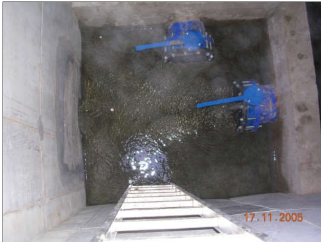
Chambre d'accès avec vidange de la galerie et trop plein en bas à droite
