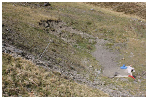
Fig.5 Éboulement et couverture partielle de l'extrémité nord du captage ; effondrement localisé au pied du personage à l'aval de la chambre de captage (2 octobre 2010)
