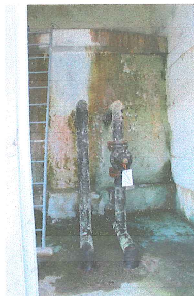
Vue intérieure du réservoir avec les départs d'adduction vers le village
