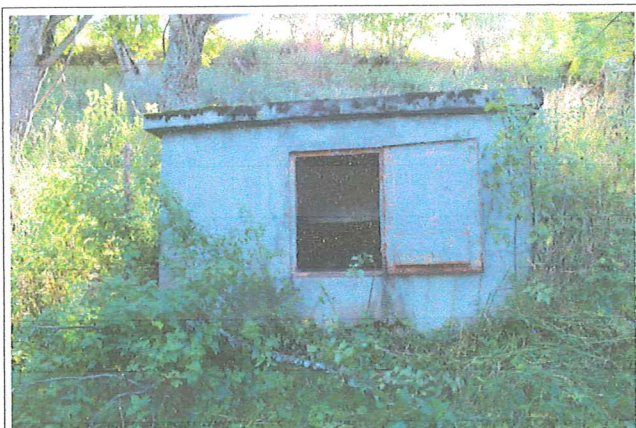
Chambre de captage
