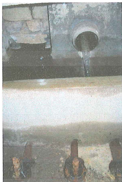
Vue intérieure de la chambre de captage composée des 2 arrivées d'eau et du bassin de décantation
