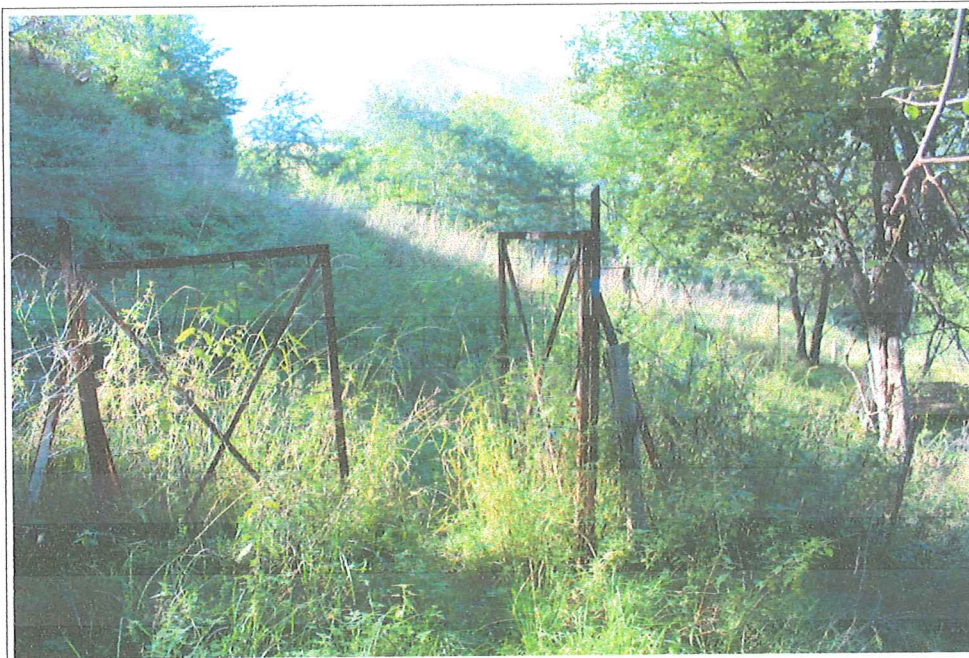
L'enceinte du captage ne répond pas aux critères de protection de la ressource en eau potable
