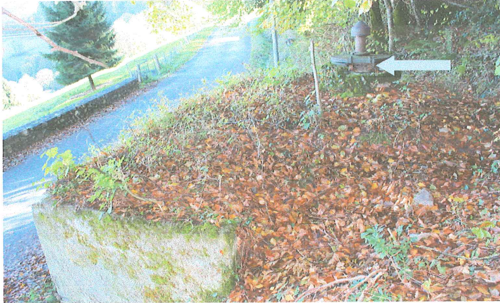
Vue supérieure du réservoir de l'Auga avec le RD.26 en contrebas. La végétation et les feuilles mortes envahissent le dessus de l'édifice. La charnière permettant l'ouverture du capot située sur le toit est cassée ( désignée par la flèche )
