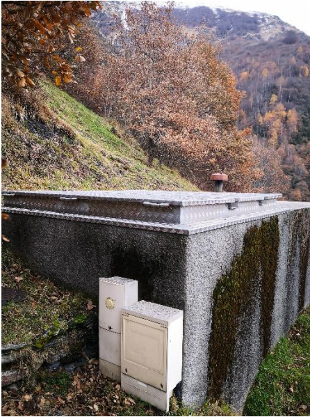
Réservoir de 5 m3 de Larbèze
